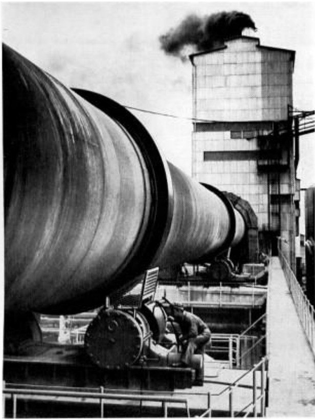
Le cuiseur du four à calciner. Le refroidisseur se trouve en-dessous et n'est pas vu sur la photo. M. Pieraci surveille les galets le jour du démarrage (comme en témoigne le panache de fumée noire...).
